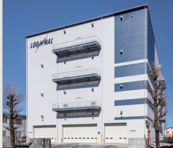
■ 厚木配送センターA棟建替計画のうち建築・設備工事（神奈川県）
